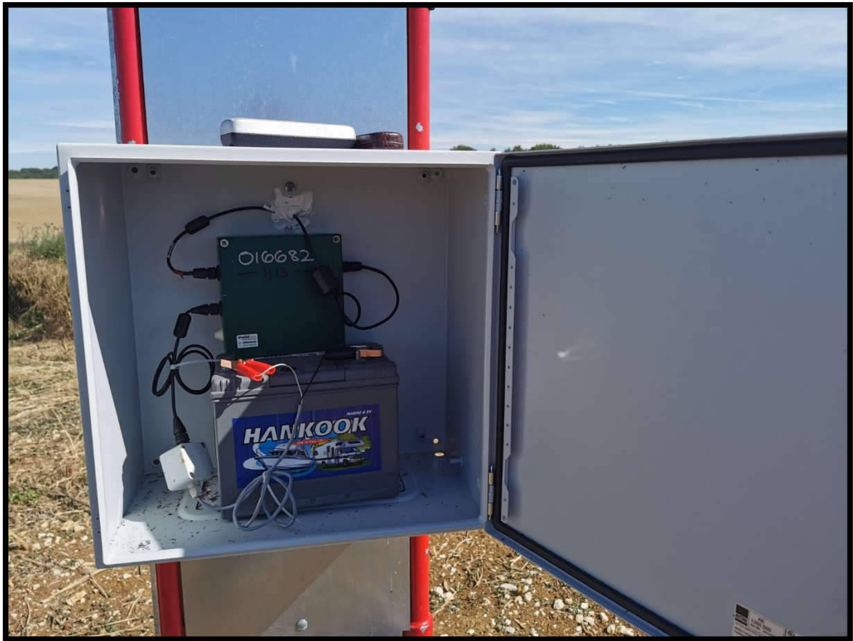
Photo n° 1 : détecteur d'ultrasons dans son coffret.
